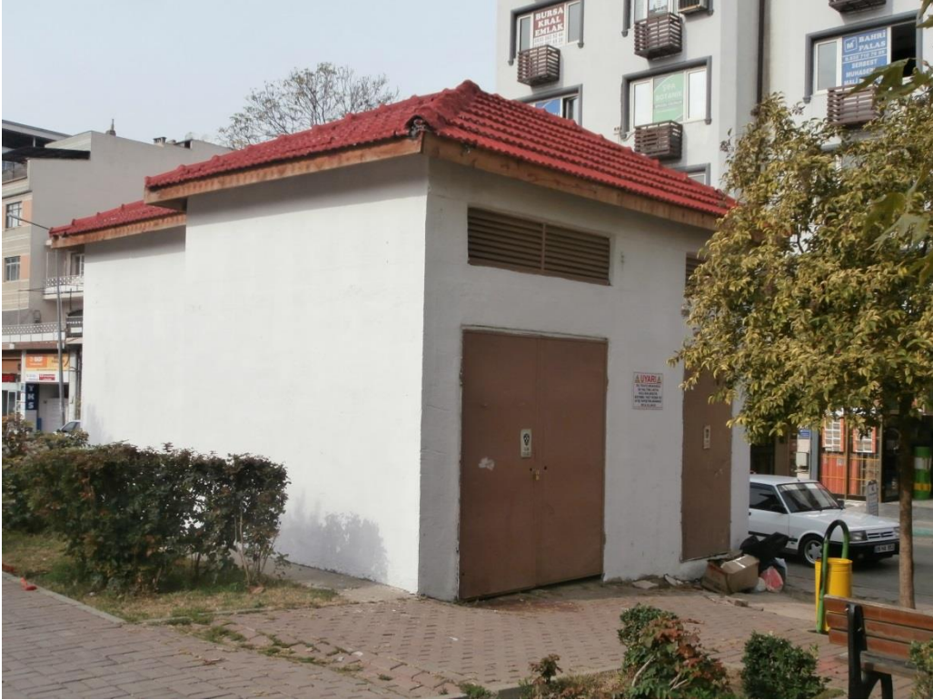
Şekil 22: Osmangazi 66 no'lu trafo renkli dış cephe boyası ve renkli reflektif kiremit boyası ile uygulanmış hali
