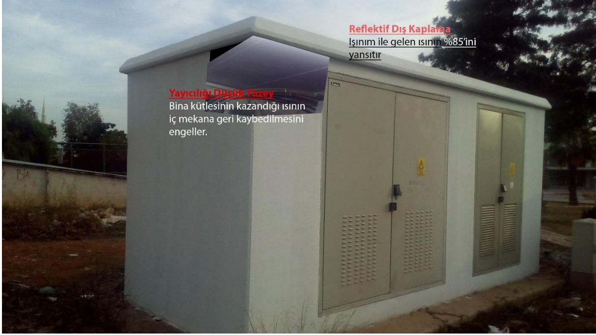
Şekil 2: İç ve dış yüzeyleri farklı malzemelerle kaplanmış trafo örneği
