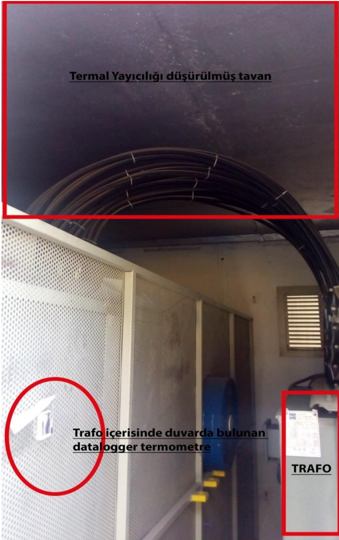
Şekil 27: Trafo İç Görüntüsü ve OG tarafta termometrenin yerleşimi
