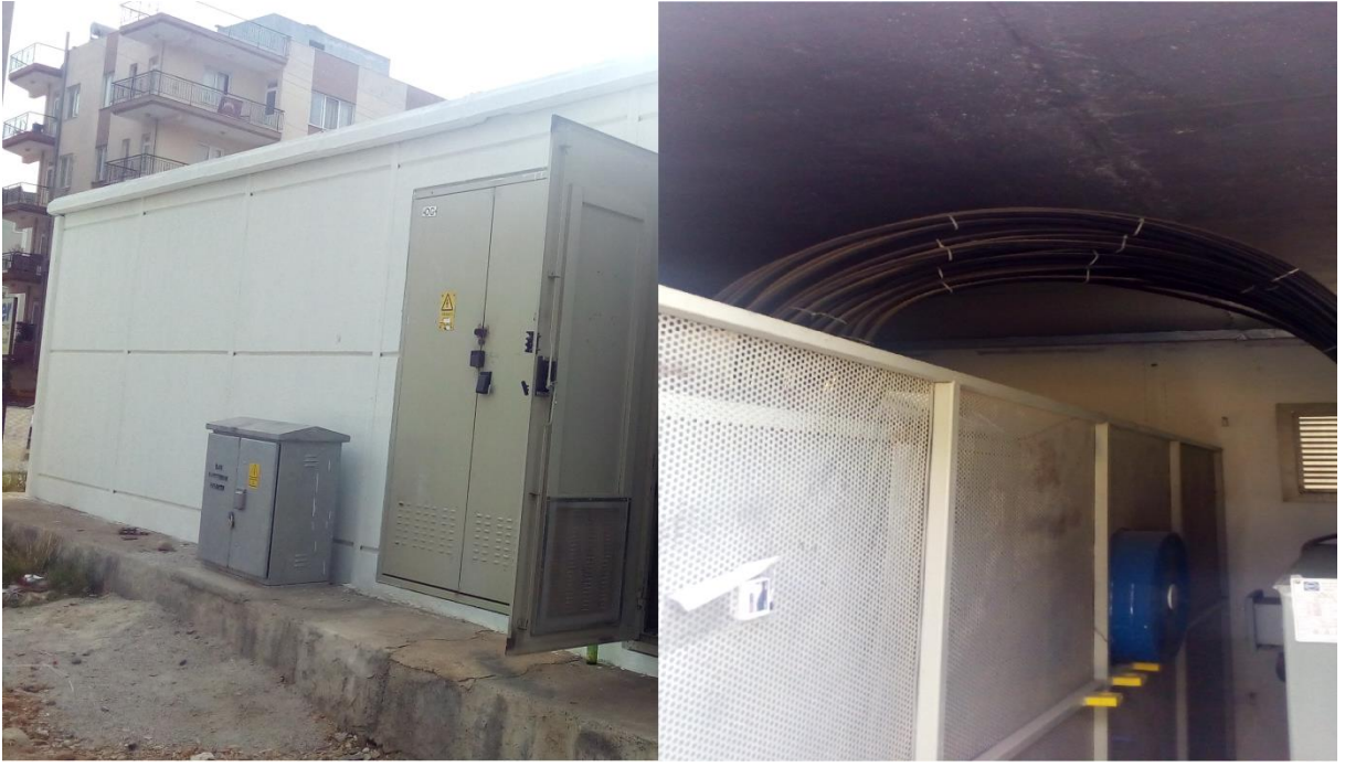
Şekil 13: Yenigün Mh. 1066 Sk. Avşar Simit Karşısı DM Uygulama Sonrası Dış ve İç Görünüm
